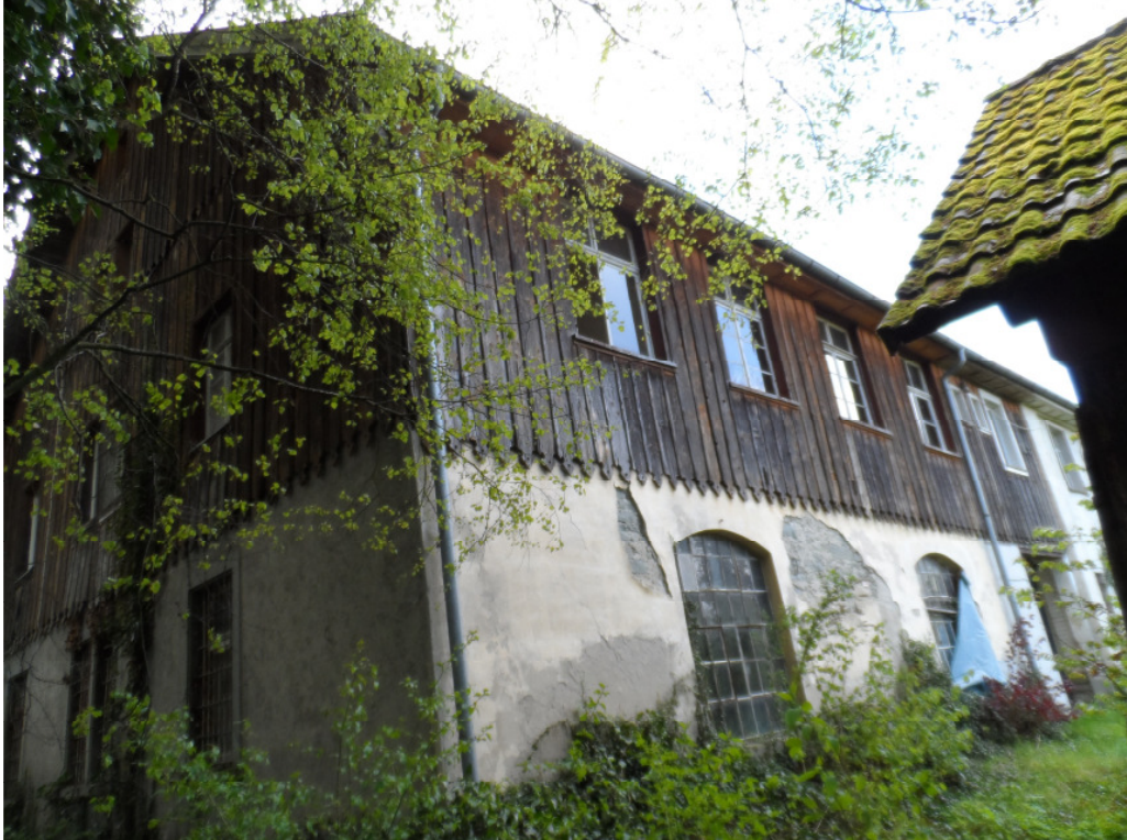
Abbildung 1: Nordwestseite des Hauptgebäudes mit vielen Spaltenstrukturen
