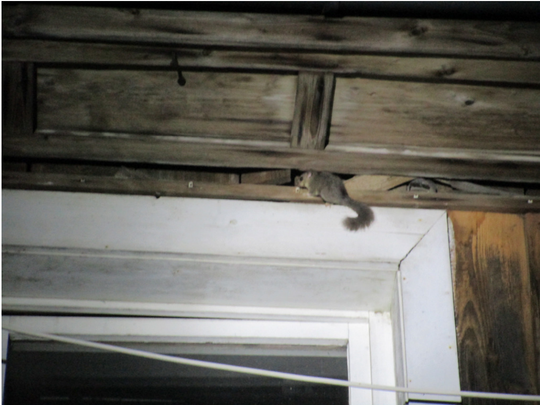
Abbildung 3: Siebenschläfer im Traufbereich Nordwestseite des Hauptgebäudes
